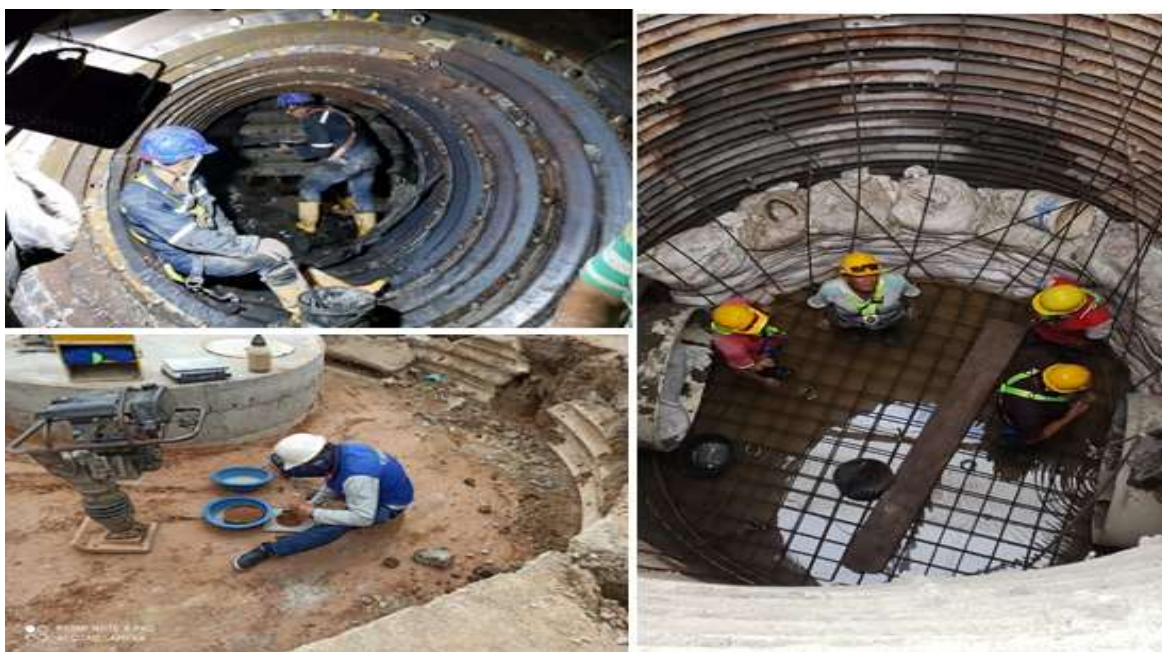
Figura No. 7 Obra CONSTRUCCIÓN INTERCEPTOR IZQUIERDO EJIDO III A TRAVÉS DEL MÉTODO CONSTRUCTIVO TUNNEL LINER
